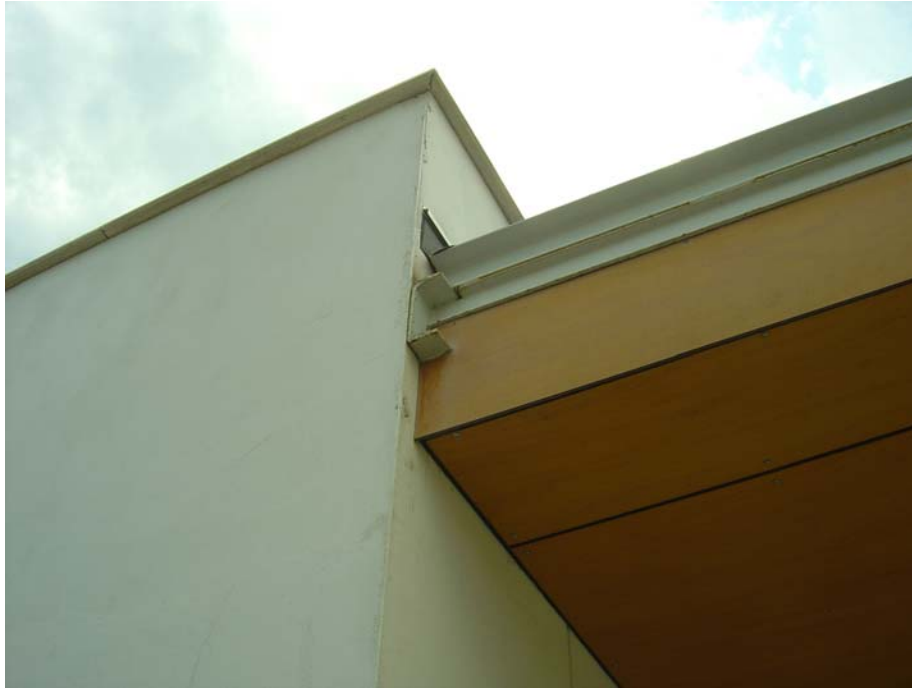
Detalle encuentro de la cubierta del porche con la fachada del edificio.
