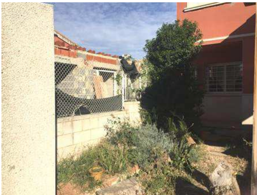
Vista general del tramo de la fachada de la edificación auxiliar que recae al interior de la parcela privativa
